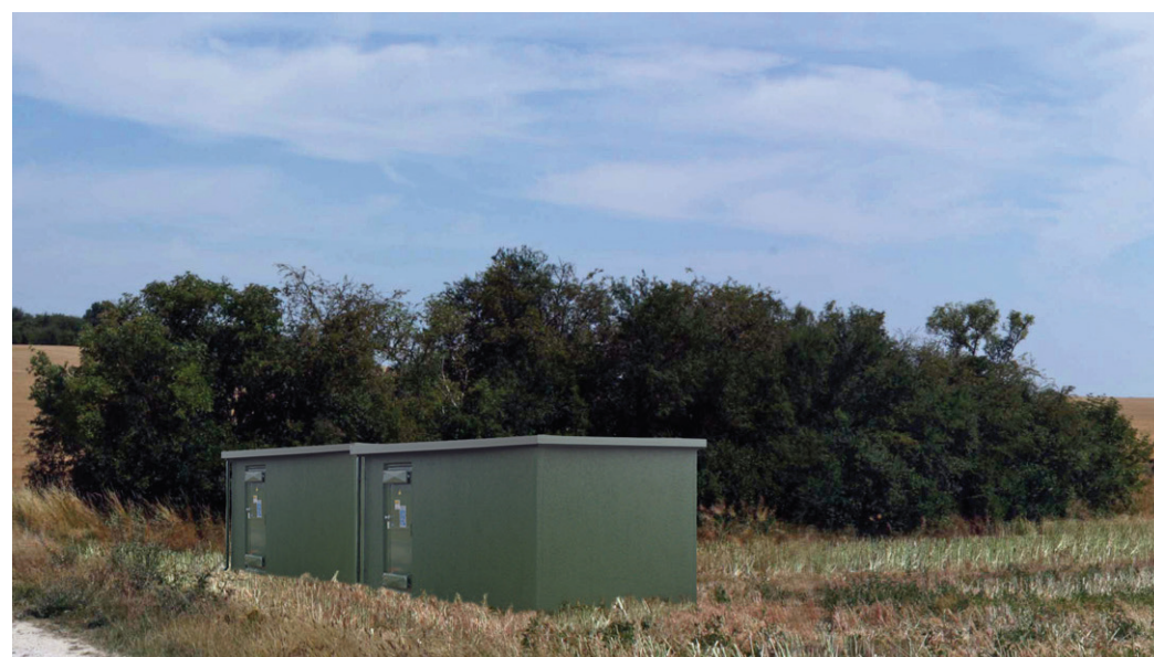
Postes de livraison.
