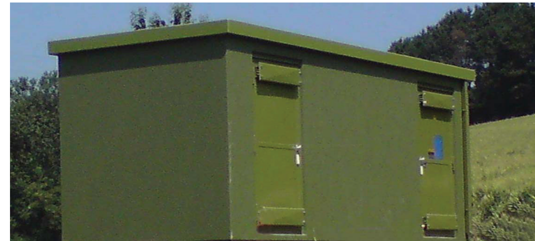
Exemple de poste de livraison
